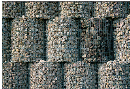
Die Rundgabionen sind hochabsorbierende Lärmschlucker.
